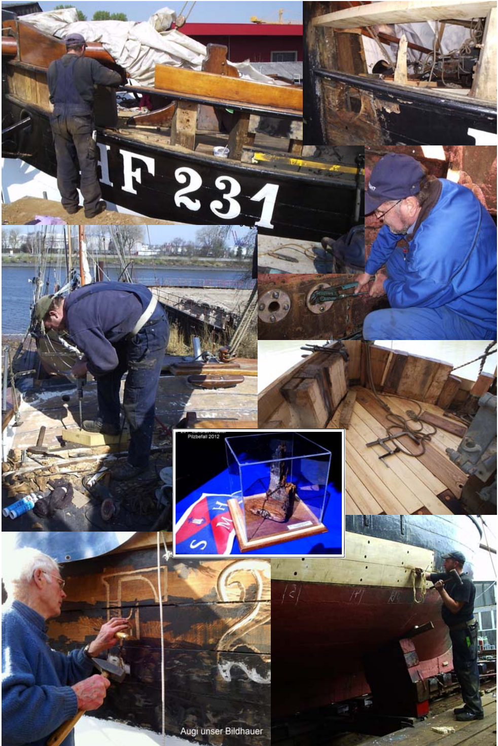
Auf Slip: Teure Reparaturen (Fotos: Archiv „Landrath Küster“)
